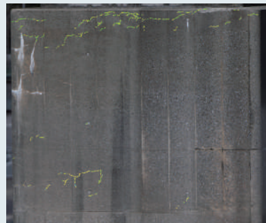
FOCUSの測定例(クラックの抽出画像) クラック幅・長さの検知精度は最小0.1mmで、最大70mの距離から撮影・検知が可能。NETIS登録：KT-130046-V NEDO*から受託開発した「空港滑走路クラック調査システム」にもこの技術が用いられた。
