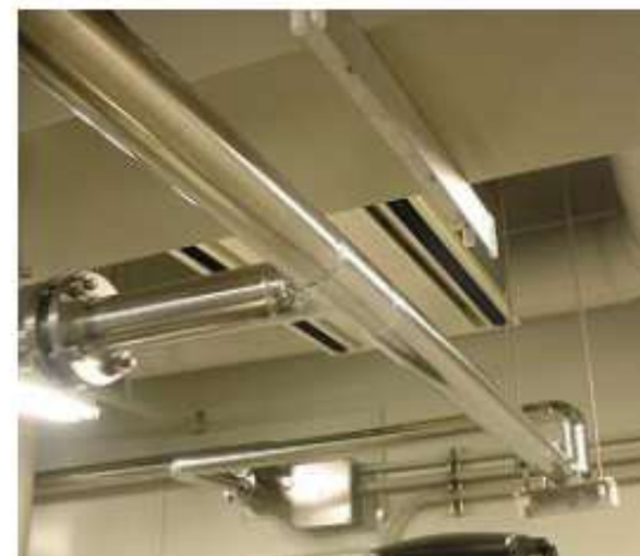
真空断熱配管
