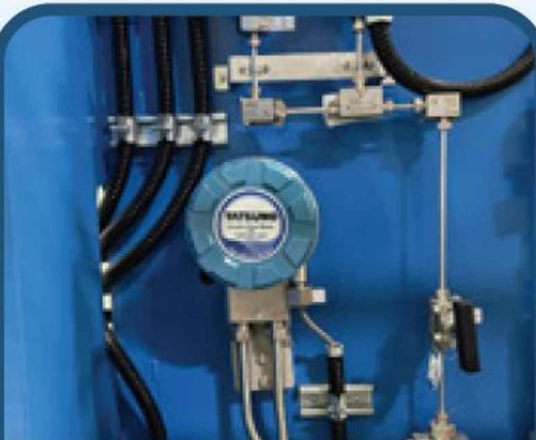
ガス試験設備
