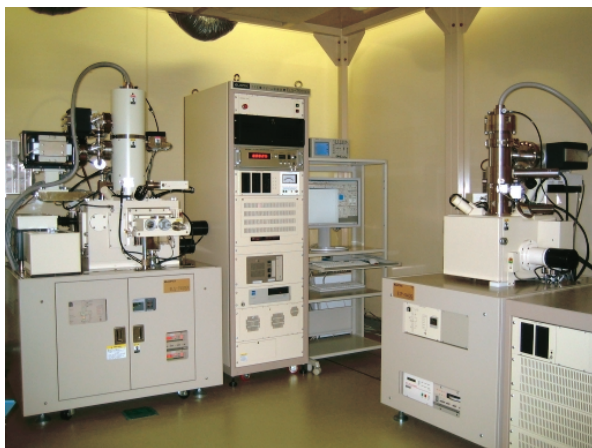
図1 クリーンルームの微細加工設備
