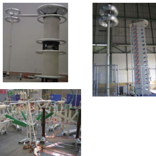
図2 交流高電圧発生装置(左上) 雷インパルス電圧発生装置(上右) 雷インパルス電流発生装置(下/イメージ)
