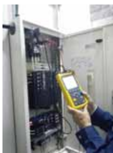
図1 工場での電氣量測定状況
