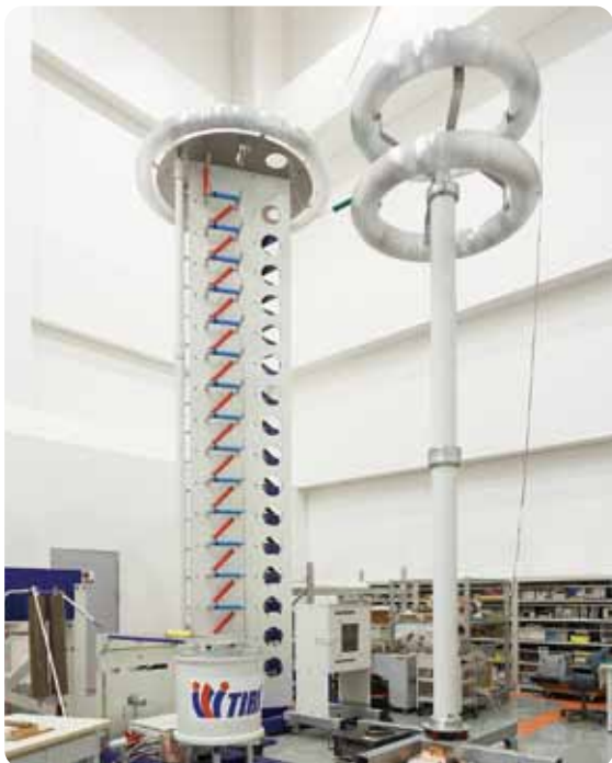
雷インパルス電圧発生装置
