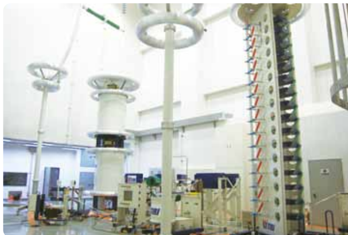
高電圧実験室の電磁波シールド
