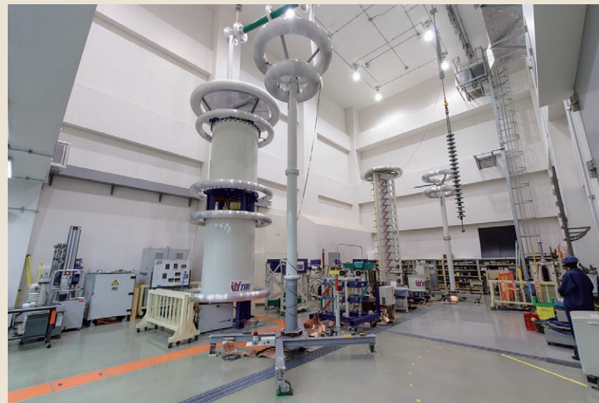
高電圧実験室
