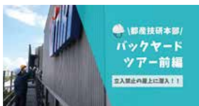
立入禁止の屋上に巨大空調設備が! 「都産技研本部バックヤードツアー」前編
